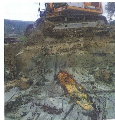
Tronc retiré au km 64'325 Source Ch. Bugnon, MFR Géologie-Géotechnique SA Bienne
