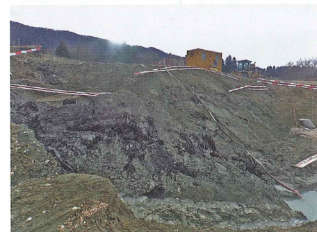
Bordure est du glissement Source Ch. Bugnon, MFR Géologie-Géotechnique SA Bienne
